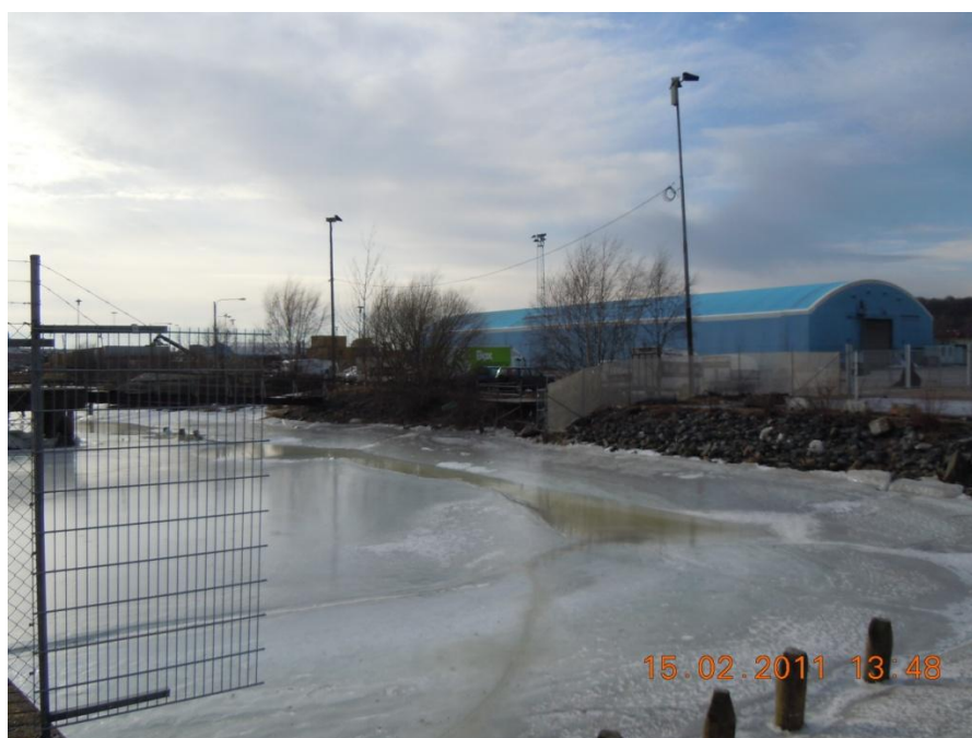
Figur 5 Erosionsskydd vid kajplats 114 inom utredningsområde, H063.
